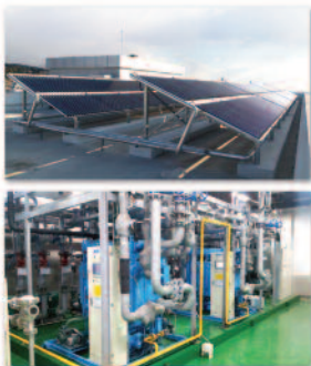
>> 제주 국제청 하이브리드 흡수식냉온수기 설치, 가동 중
